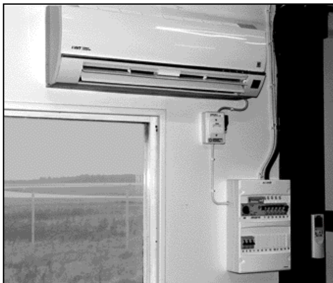
Fem stycken värmepumpar i västra gaveln blåser in varm och skön luft i hangaren. Separat elnät och elcentral har dragits till pumparna.
